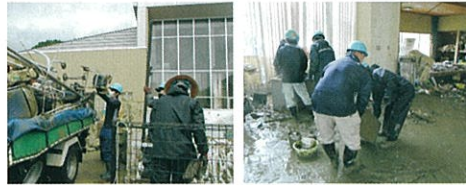
球磨村千寿園(高齢者福祉施設)で屋内被災物搬出や汚泥撤去
